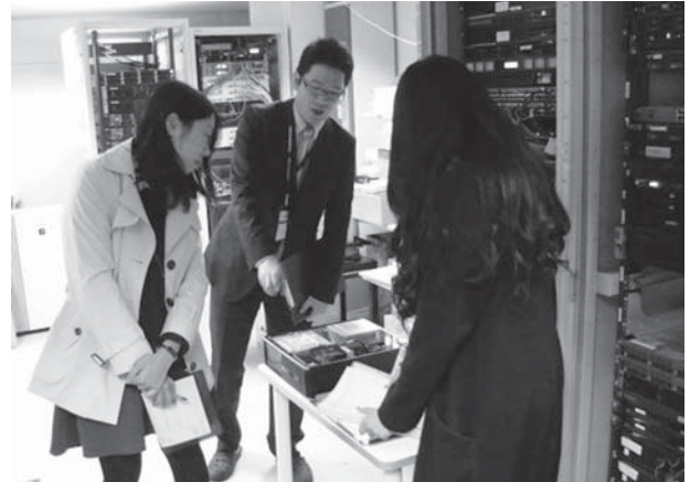
図3 サーバー室見学でのシステムエンジニアによる説明
