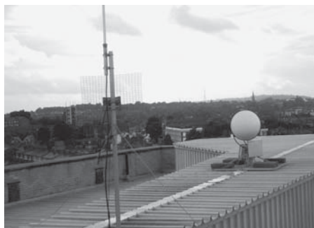
図6 区民ホール屋上に設置されたバウンドレスのアンテナ設備
